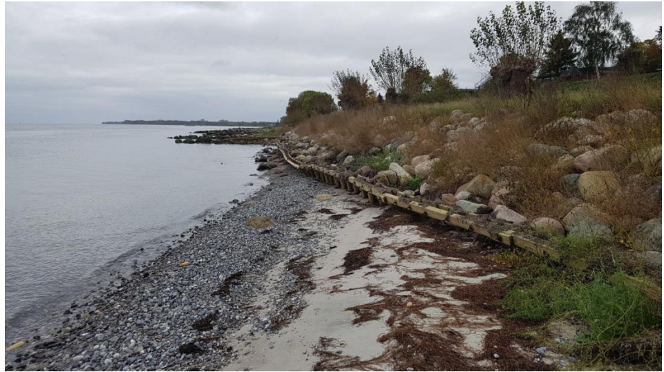
Figur 4.40: Palisadevæggen, der holder på skråningsbeskyttelsen, er ved at bryde sammen, st. 4710-4790.
