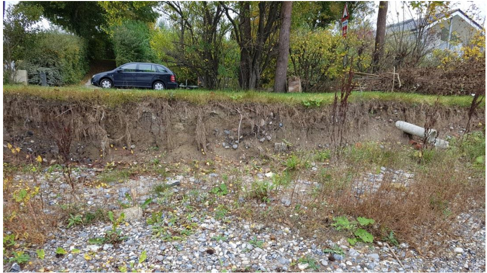
Figur 4.35: Skråning uden beskyttelse udsat for erosion.
