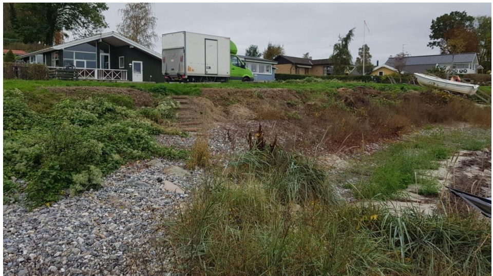
Figur 4.42: Ubeskyttet skråning med ral for foden af skråningen, st. 4170-5760.
