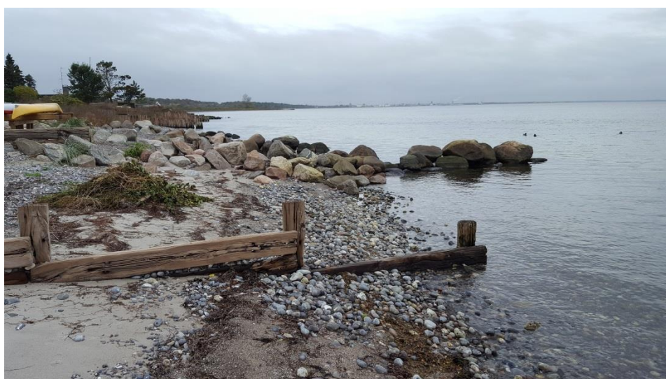
Figur 4.12: Eksempel på dårligt konstrueret stenhøfde og træhøfde, hvor langsgående sediment kan strømme gennem høfderne, st. 1050.
