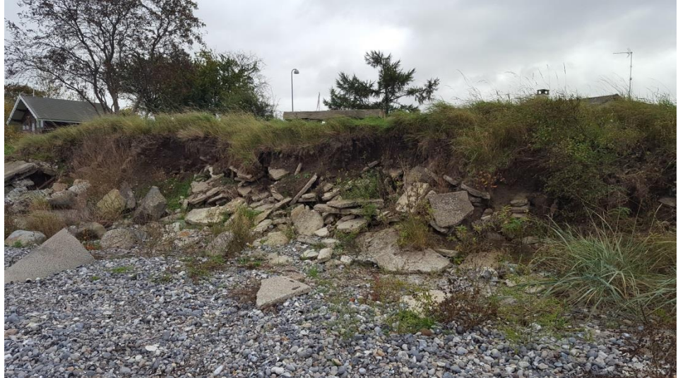
Figur 4.23: Skråning udsat for erosion og forsøgt beskyttet med fliseaffald, st. 2520.
