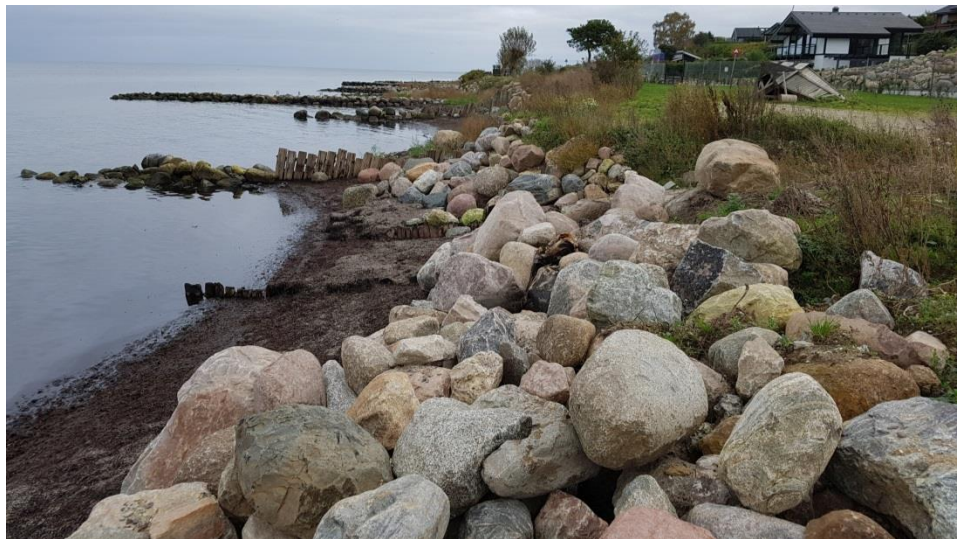
Figur 4.36: Ny stenkastning uden rallag. Dækstenene ligger ikke stabilt, st. 4440-4560. Høfderne på billedet har ingen funktion.
