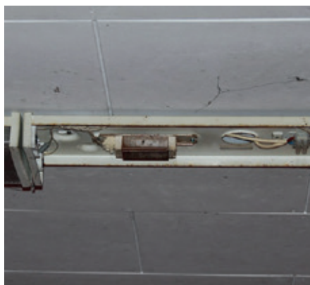
Ældre armaturer til lysstofrør indeholder ofte PCB.
