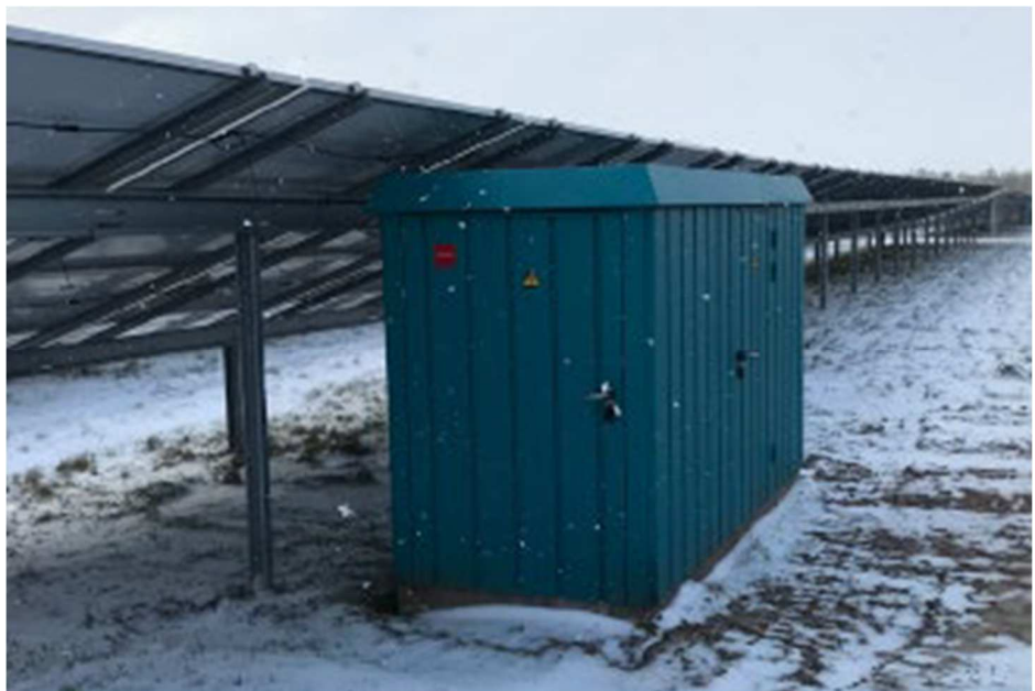
Figur 5 Eksempel på en mindre transformer som skjules under solcellepanelerne.
