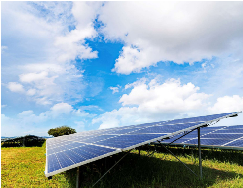
Eksempel på solcellepaner på fastmonteret stativ.
