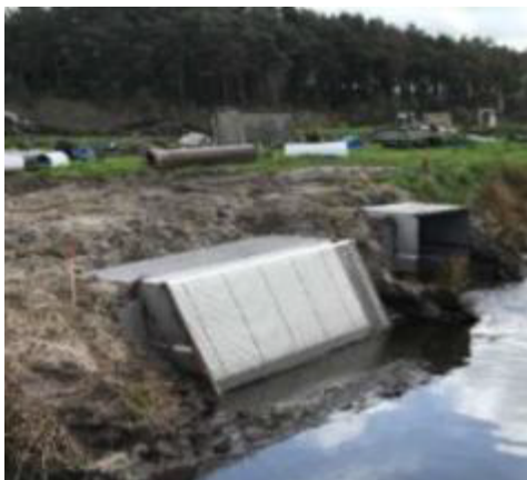
Figur 1: Indløbsrist forrest i billedet
