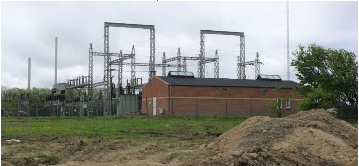
Eksisterende transformerstation ved Ringkøbingvej.
