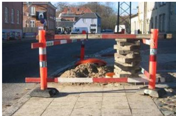
Billede 11: Delvist korrekt opstillet vej- arbejde i Jyderup. Der mangler vejledning til de gående om at de skal skifte fortov.
