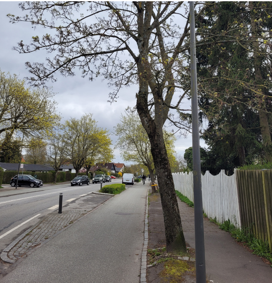
Hjortespringvej ved Lidsøvej - orienteret mod syd. Her ses den meget trænge fortovsbredde, som er særligt gældende fra strækningen fra Lidsøvej til krydset ved Vindebyvej, samt den hævede belægning som skyldes trærødderne.
