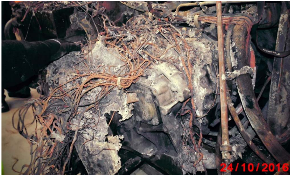
Billede 7. Skader på ledningsnet
