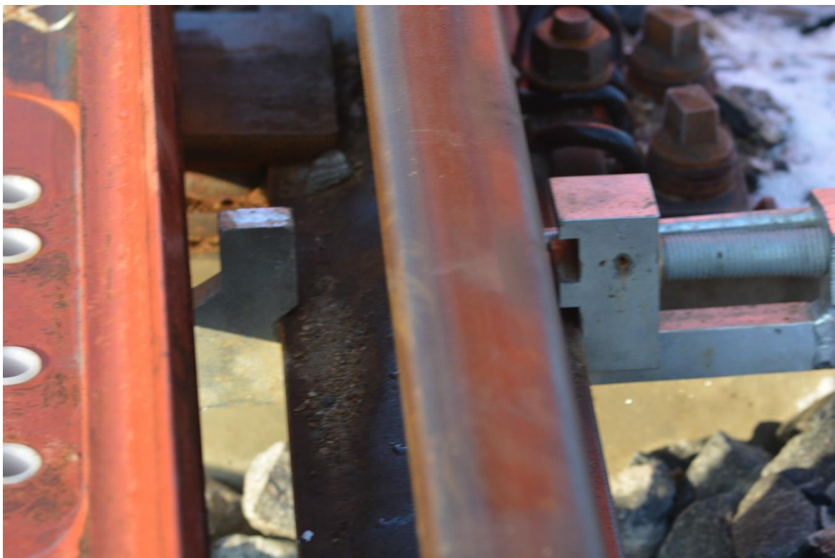
Foto 3 Låsebolt type 2002 monteret udvendigt på sideskinnen med skinnefoden nederste hak i anlægsklodsens. Låsearm ikke fuldt på plads.
