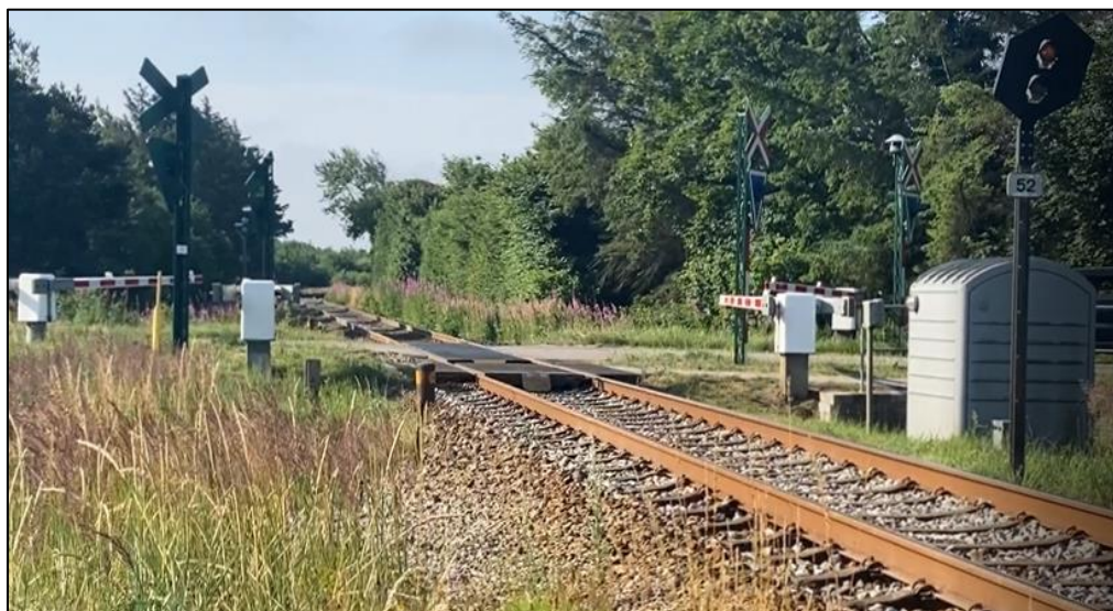
Foto 1. Foto taget i retning fra Hirtshals mod Tornby. Overkørsels relæhytte (grå hytte) placeret ved siden af cykelsti på den nordvestlige side af Søndergade. Hytte, hvori sikringsmontøren udførte fejlretningsarbejde på ulykkestidspunktet.
