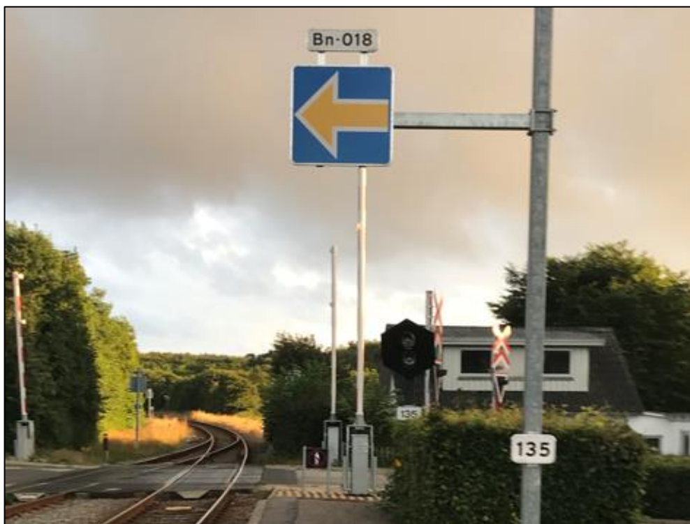
Foto 10. Slukket overkørselssignal på Bedsted station (Thybanen) efter indførelse af ETCS. Foto taget af HCLJ i juli 2021.
