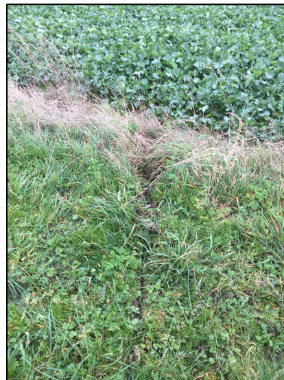
Foto 2: Overfladiske skader på volden.
