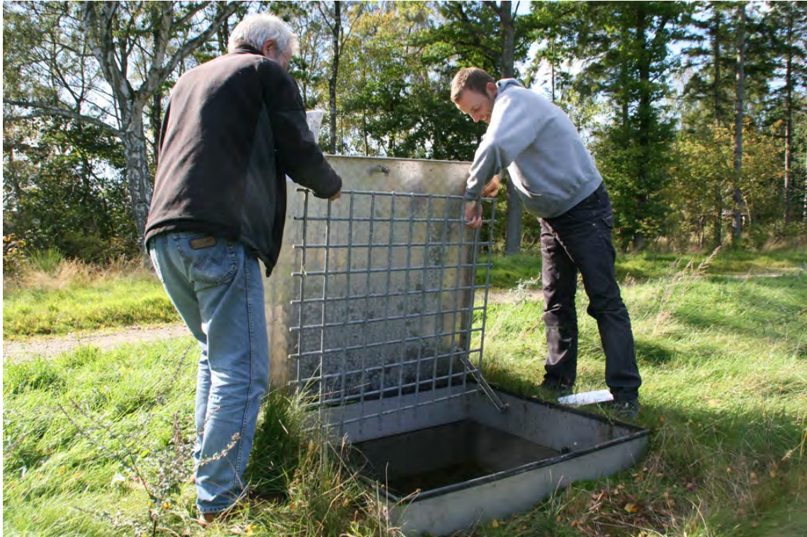
Figur B4-7 Konstruktion ved Sø ovenfor Kejlstrupgrøft tilløb opstrøms motorvej
